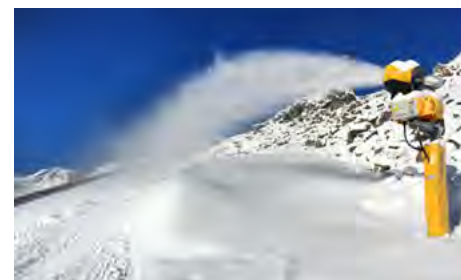
Eine Armada der weißen Pracht: Insgesamt stehen im Skigebiet 363 Schneeerzeuger im Einsatz.
